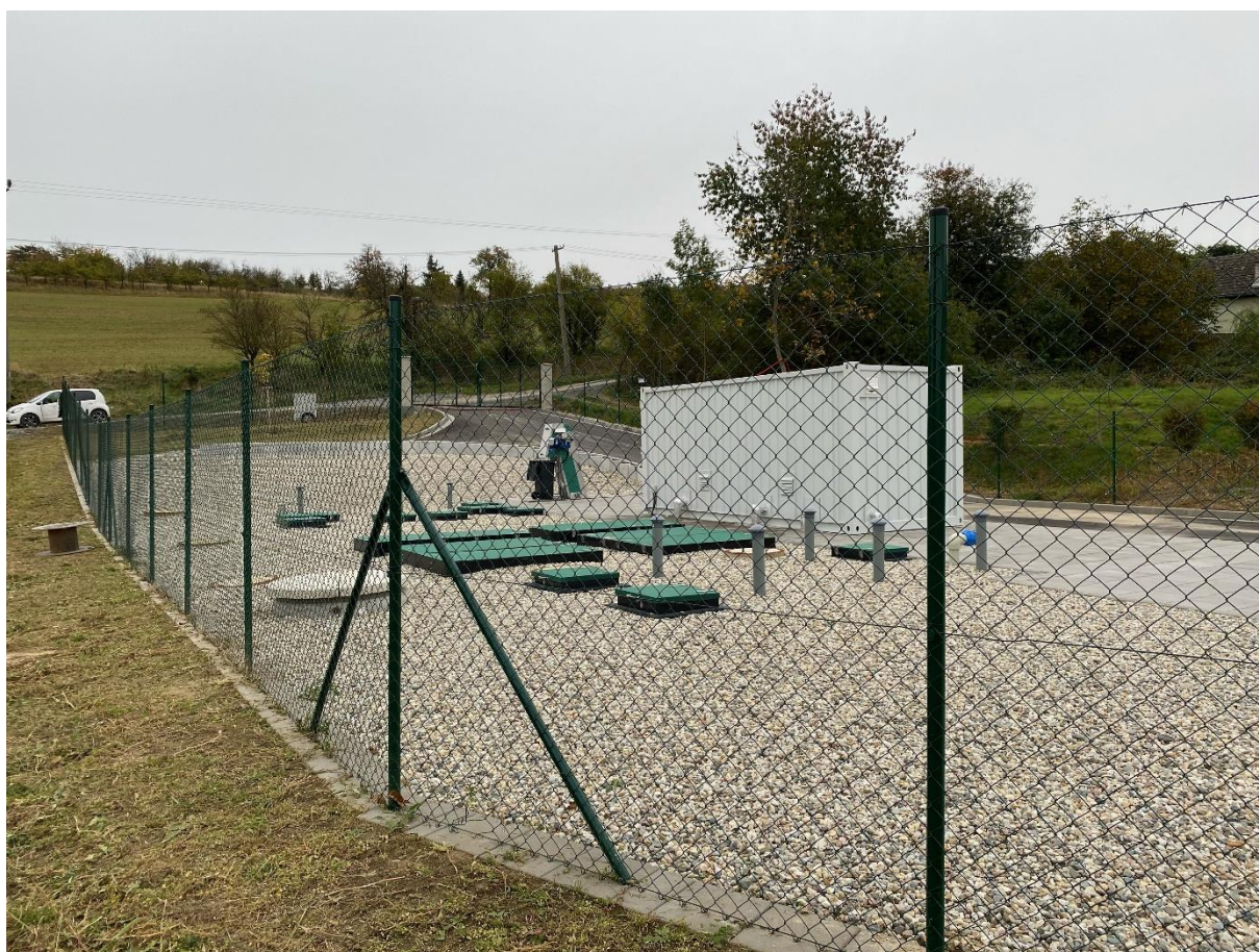
Čistírna odpadních vod Nová Dědina
